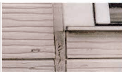
シーリング材に生じた部分的なひび割れの例
