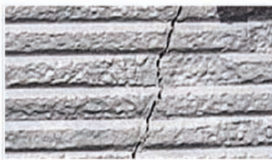
サイディングに生じた破損の例
