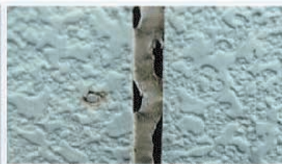
シーリング材に生じた剥離の例
